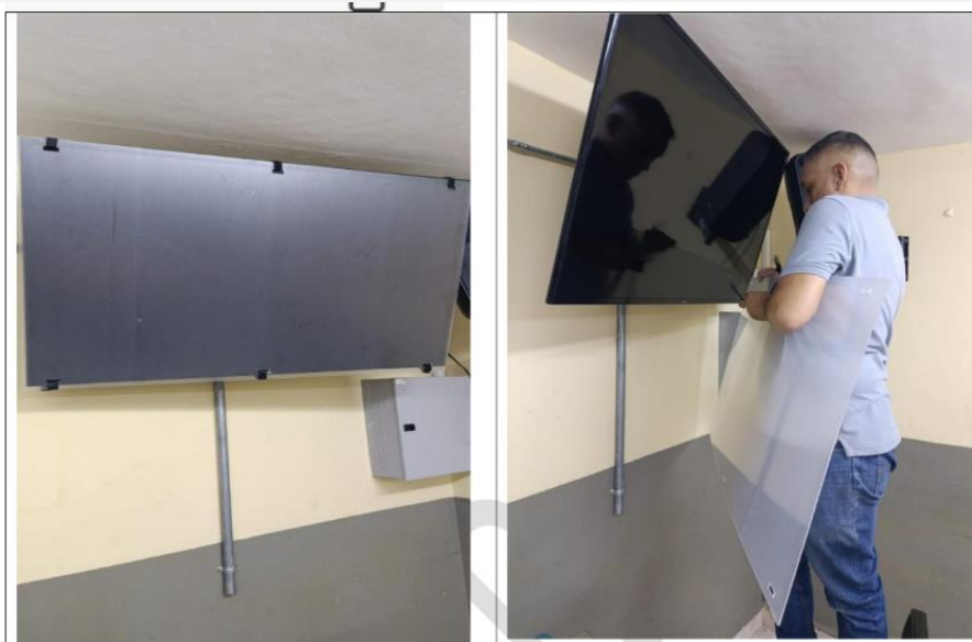
Instalación de pantallas de protección a tv
